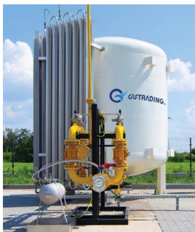
Stacja Regazyfikacji LNG
