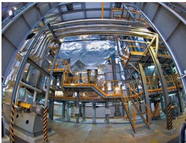
Instalacja Termicznego Przekształcania Osadów
